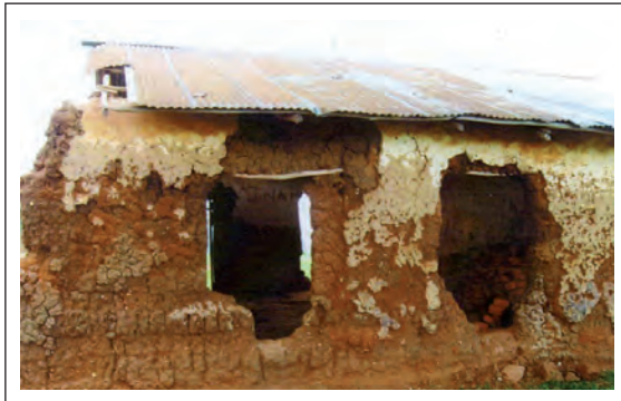
Bumumali; oft werden Kinder in einsturzgefährdeten und überfüllten Klassen unterrichtet
